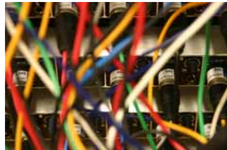
(b) Detailaufnahme des Vorverstärker Racks
